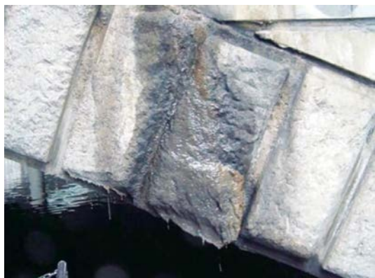
写真-4 損傷状況 (側面の石灰分しみ出し)
