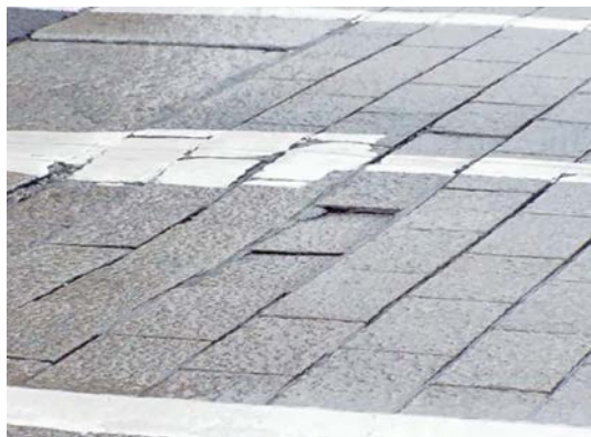
写真-3 損傷状況 (表面のひび割れ)
