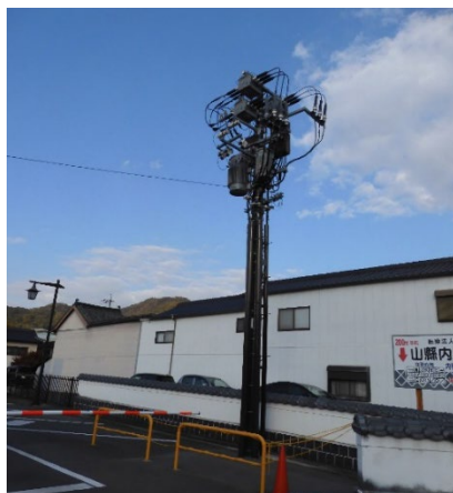
【配置場所を工夫した変圧器】
